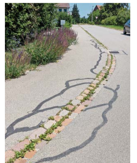
Die Langenmooserstrasse enthält viele Risse, vor allem an den Rändern und im Bereich des Trottoirs. Bild: msa
